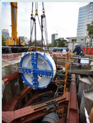
厚木排水区浸水対策北貯留管を掘削するシールド先端部
