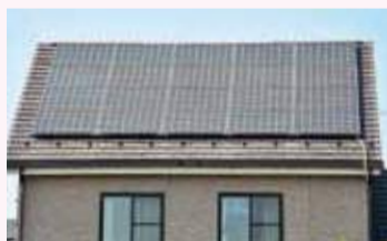
住宅用の太陽光パネル
