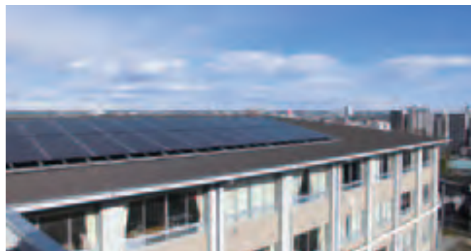
南毛利中学校に設置された太陽光パネル
